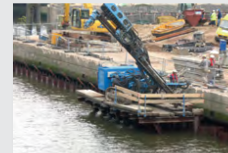
Реконструкция причального сооружения, установка анкеров ТИТАН с понтона, прикрепленного к новой шпунтовой стенке в г. Гамбурге, Германия.
